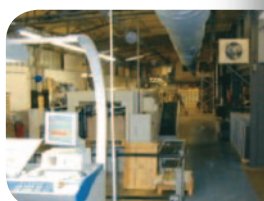
Nouveau système de climatisation, Intérieur.
