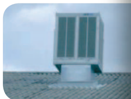
Nouveau système de climatisation, Intérieur.
