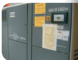
Nouveau compresseur à vis à vitesse variable
