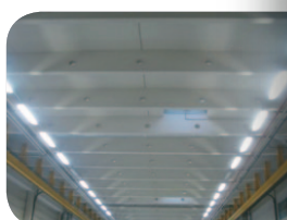
Nouvel éclairage de l'atelier
